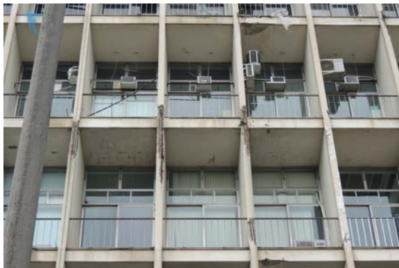
Figura 10 – Aumento de seção das barras de aço expostas e oxidadas em pilares na da fachada sudeste do bloco A do edifício JMM. Fonte: Acervo do Autor.
