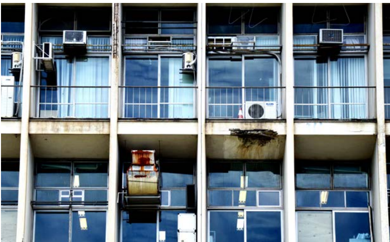
Figura 14 – Perda de cobertura nas lajes das sacadas, manchas superficiais e perda de revestimento cerâmico na fachada sudeste do bloco A do edifício JMM.
