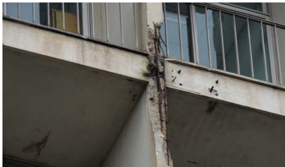
Figura 11 – Flambagem e o rompimento de armaduras de aço dos pilares da fachada sudeste do bloco A, demonstrando a diversidade e a gravidade que dos sintomas patológicos. Fonte: Acervo do Autor.
