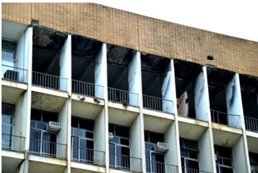
Figura 9 – Destaque para os reflexos do incêndio no oitavo andar: manchas nas superfícies das lajes, guarda-corpos destruídos e armaduras de aço expostas.
